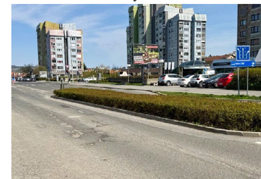
SLIKA 10: UNIČENO VOZIŠČE NA KARDELJEVI CESTI
