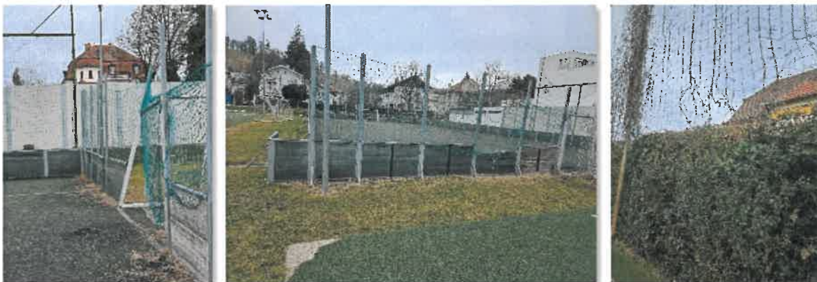
Dotrajani in razmajani lovilci, raztrgane in poškodovane lovilne mreže
