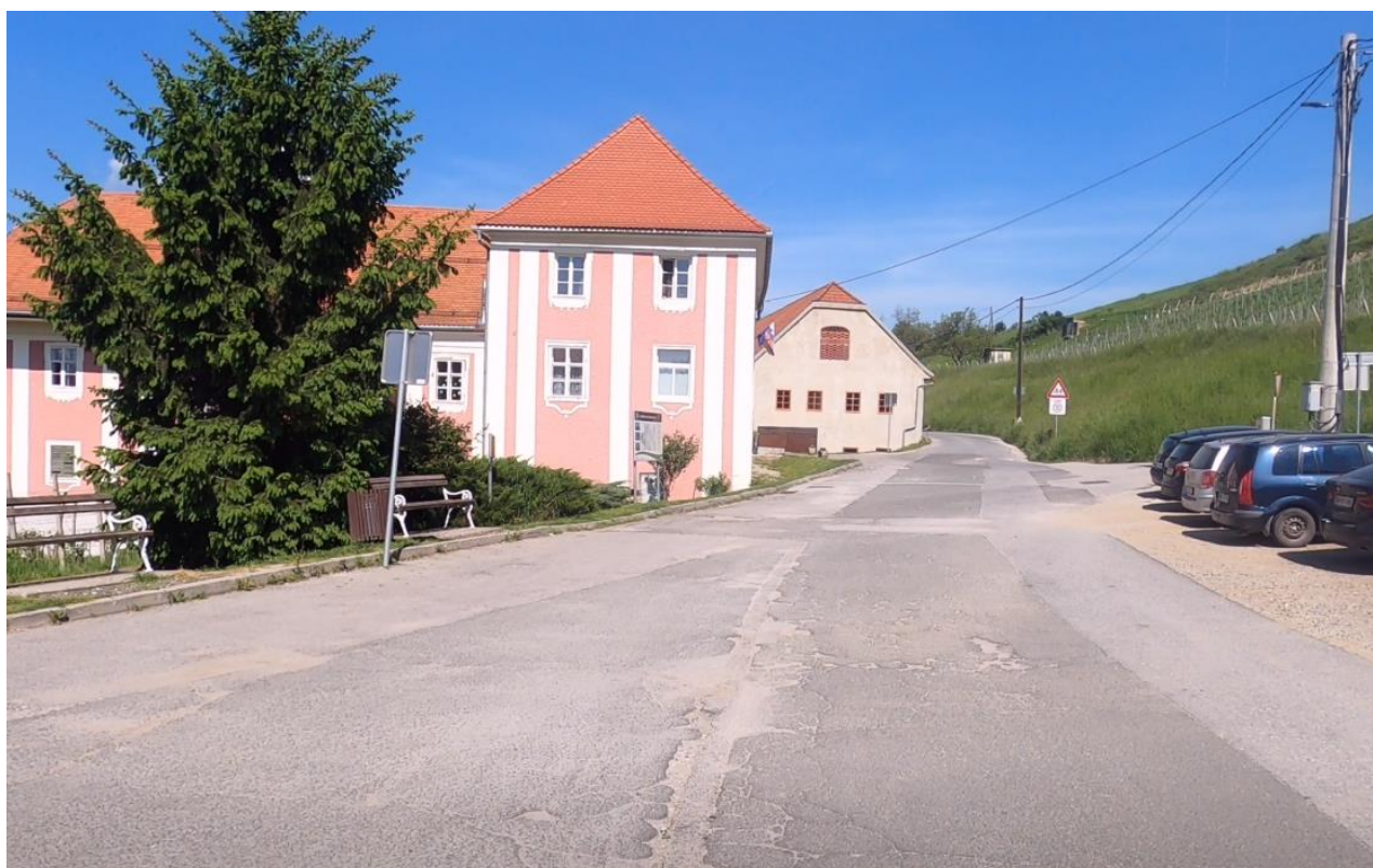
Slika 3: Poškodbe vozišča pred cerkvijo v Malečniku
