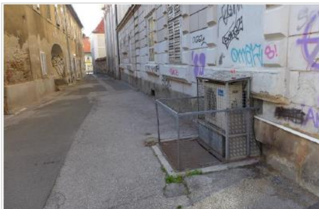
Slika 10: Zunanja enota prezračevalne naprave s požarno loputo v Gospejni ulici
