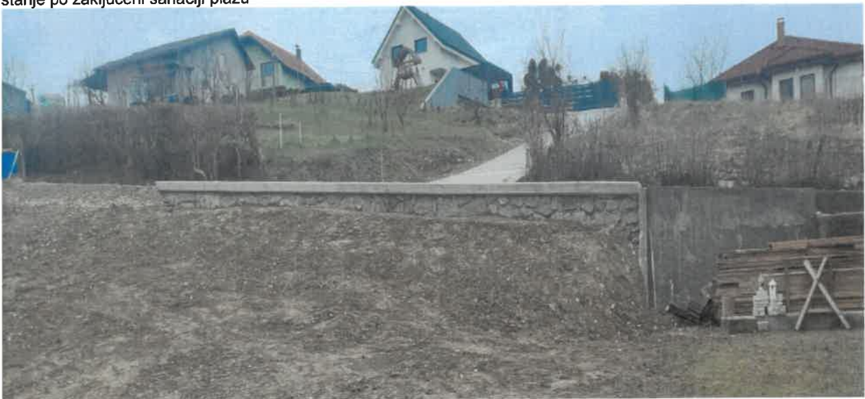
Sklop 15 (ID AJDA: 1239761): Sanacija udora in rekonstrukcija ceste JP 745942 v območju HŠ Ruperče 42h – Izvedeno stanje po zaključeni sanaciji plazu
