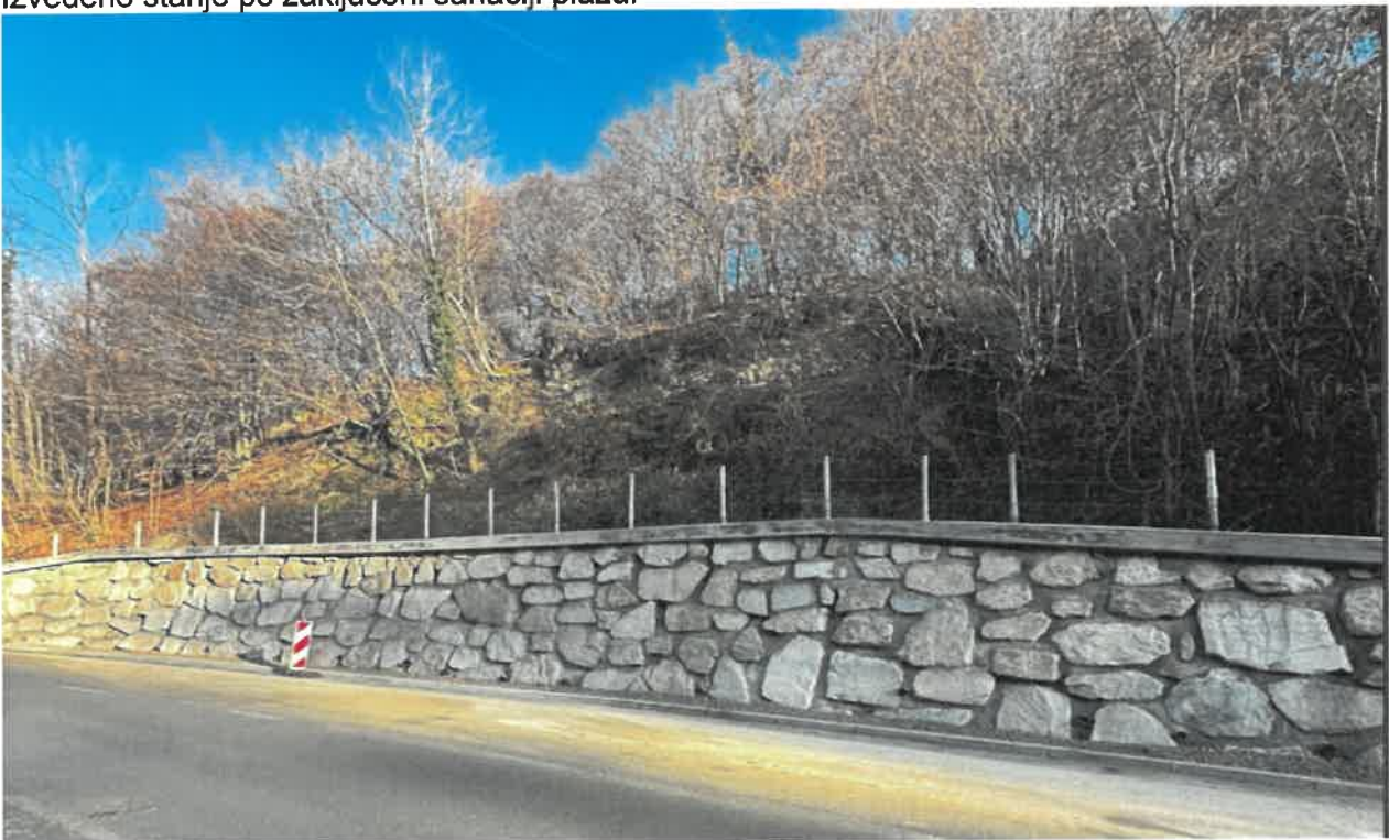
Sklop 17 (ID AJDA: 1240297): Sanacija udora in rekonstrukcija ceste LK 242953 - Trubarjeva ulica. Izvedeno stanje po zaključeni sanaciji plazov:
