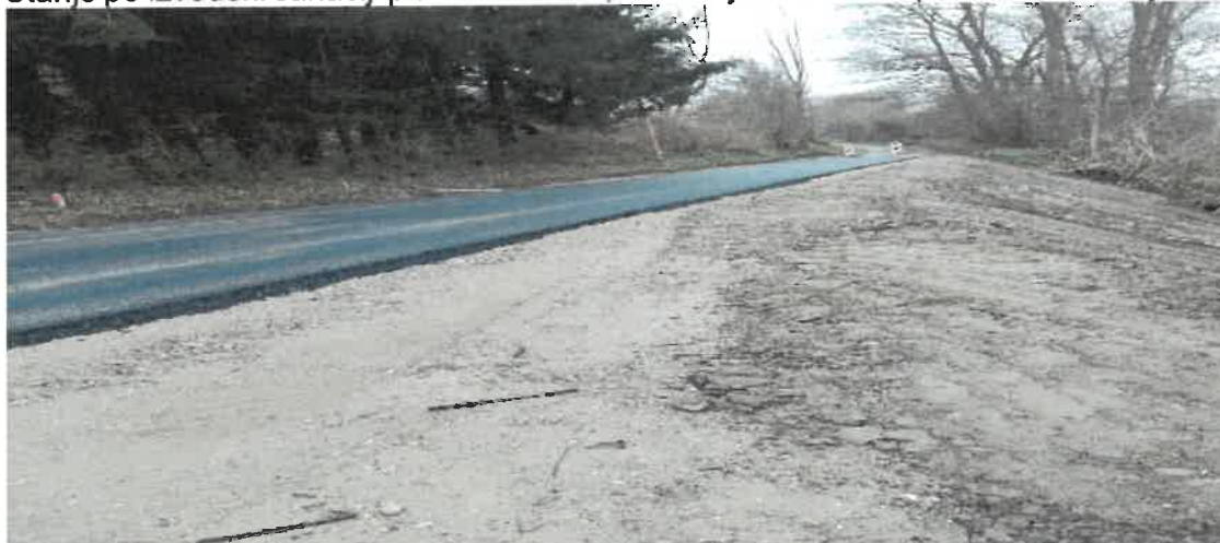
Stanje po izvedeni sanaciji plazu – brežina, v kateri je izvedena oporna konstrukcija in kamnita rebra:
