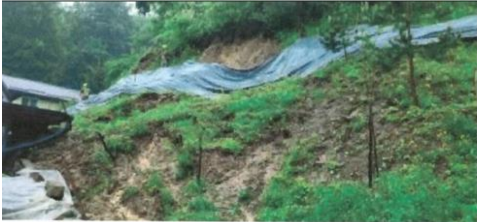
Sklop 21 (ID AJDA: 1250992 ): Sanacija plazzu nad stanovanjskim objektom v območju HŠ Pod Urbanom 3
