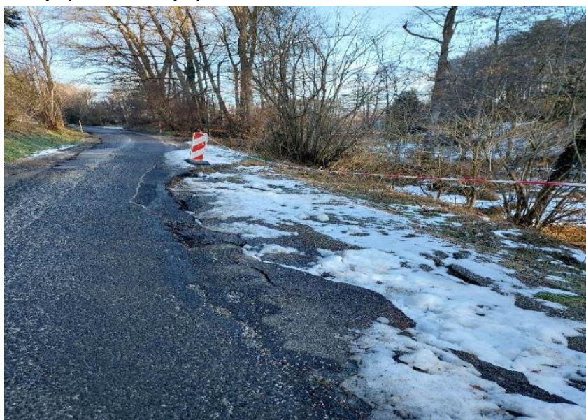
Stanje pred sanacijo plazu:
