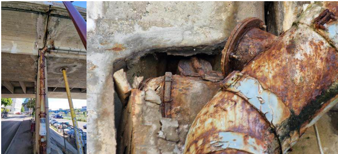
Posledice zamakanja in poškodovano ležišče na Loški ulici
