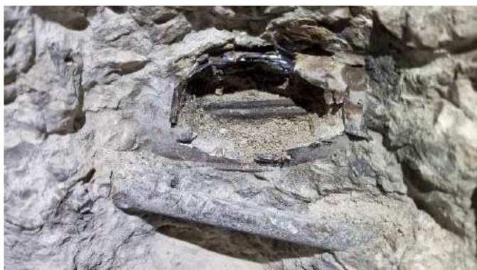
Slika 2: Jeklo kabla po odstranitvi zaščitnega sloja betona, odprtju kabelske cevi in delni odstranitvi injekcijske mase
