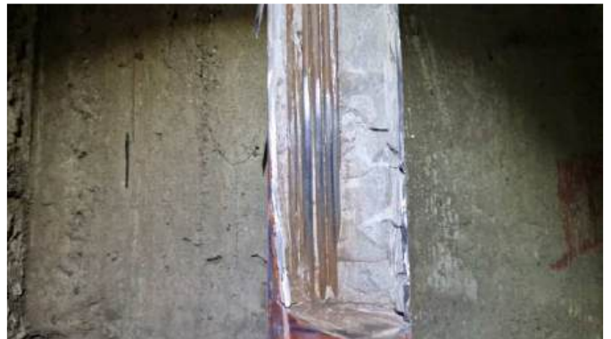
Slika 7: Isti vertikalni kabel po delni odstranitvi injekcijske mase
