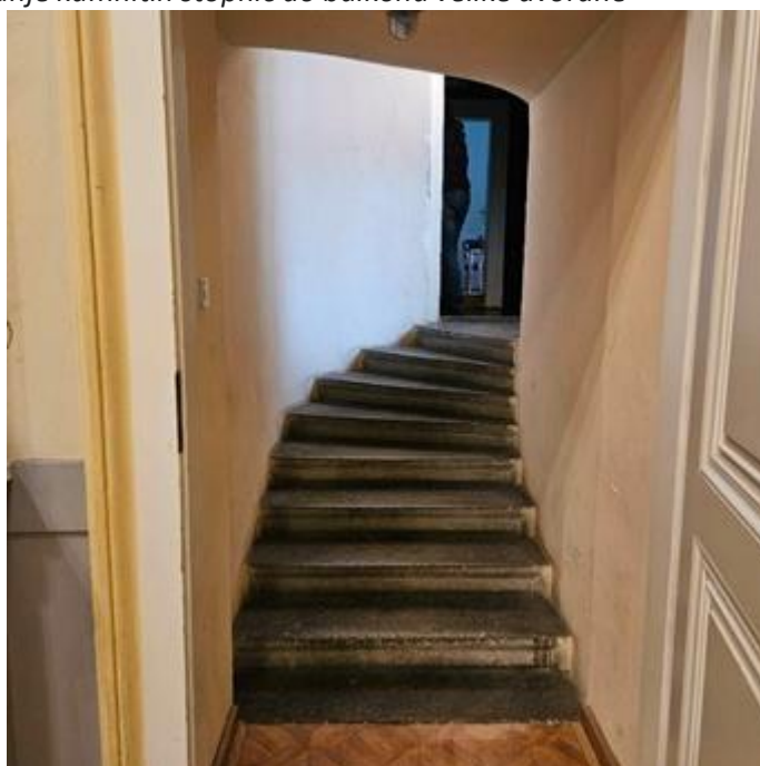
Slika 10: Obstoječe stanje kamnitih stopnic do balkona velike dvorane
