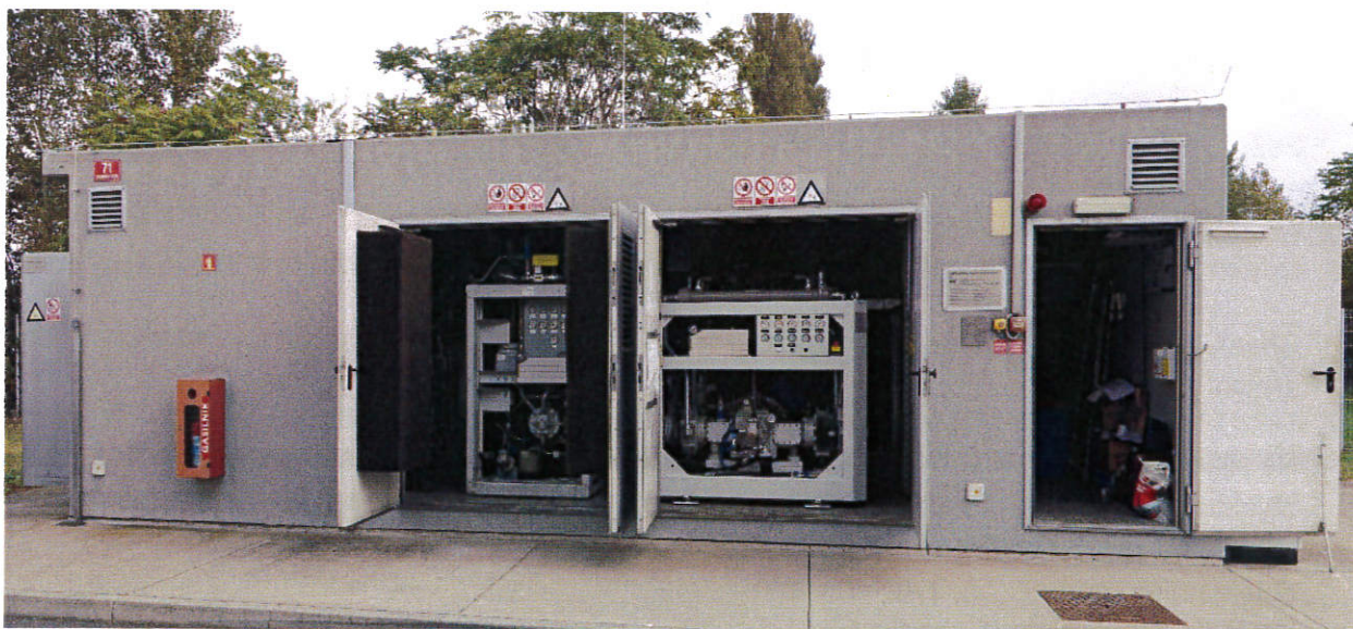
Slika 2: Montažni objekt z opremo
